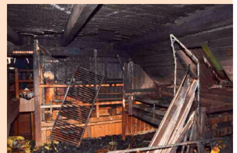
Das völlig ausgebrannte Schlafzimmer
